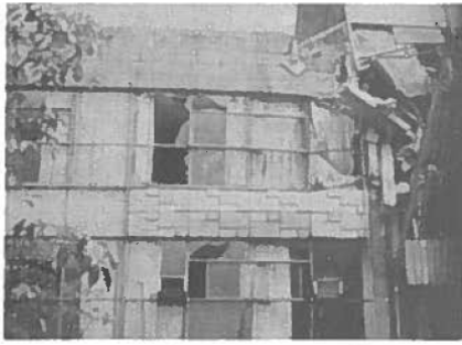
شكل (١٠) تصادم المبنيين بسبب عدم وجود عرض كافٍ للفواصل
